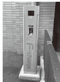
電気自動車充電設備
