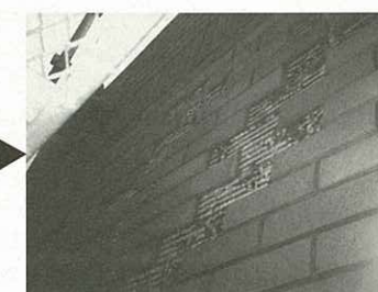
「浮き」部分をはがした状態
