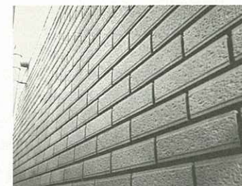
修繕工事前の深目地 (とところどころにタイルの「浮き」があった)
