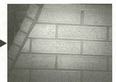
目地部分をコテ塗り込みで仕上げた完成外壁 (結果的に深目地が浅目地になった)
