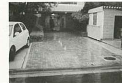
▲100分の1の勾配の全面スロープに改修。材質は滑りにくいインターロッキング
