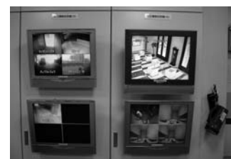
▲防災センターには、4台のカラーTVモニターを設置。29台の防犯カメラで映し出された映像はハードディスクやビデオテープに記録されます
